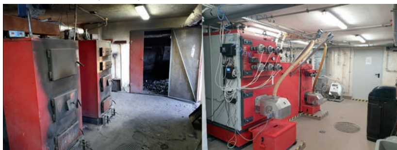
Stara i nowa kotłownia w budynku Ośrodka Zdrowia
