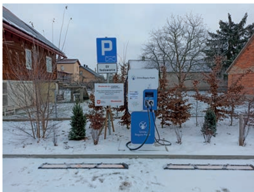
Stacja ładowania pojazdów elektrycznych
