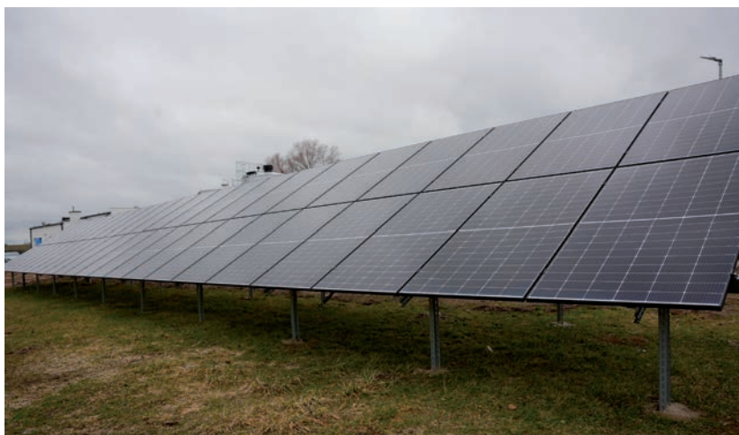
Instalacja fotowoltaiczna przy SUW w Zawistach Dworakach
