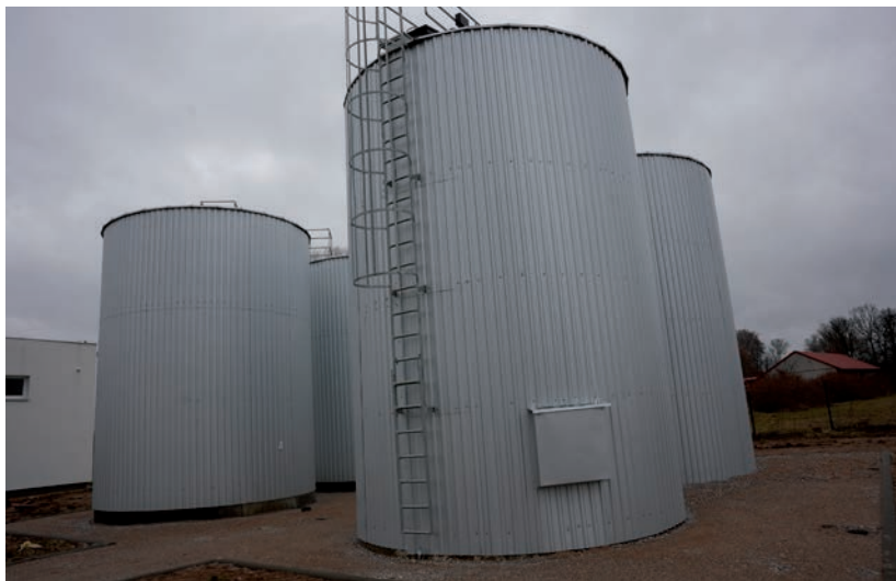
Zbiorniki retencyjne przy SUW Zawisty
