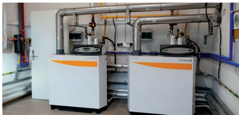
Kotłownia przy Szkole Podstawowej w Bogutach-Piankach
