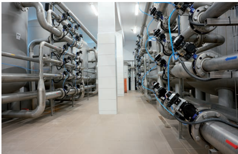
Stacja uzdatniania wody w Zawistach Dworakach
