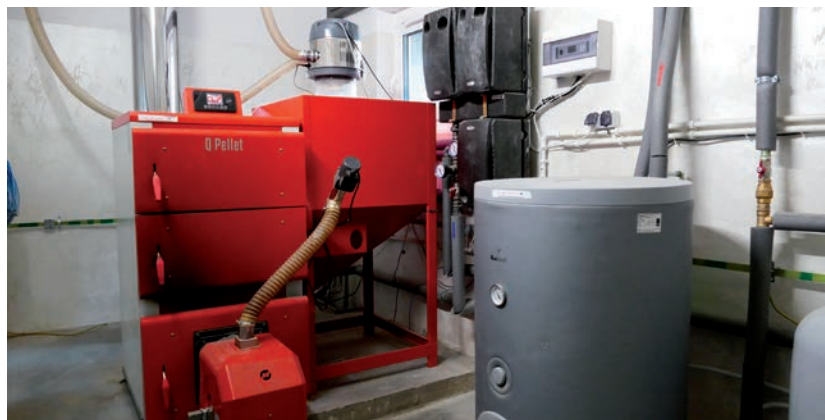
Kotłownia w budynku GOKiS
